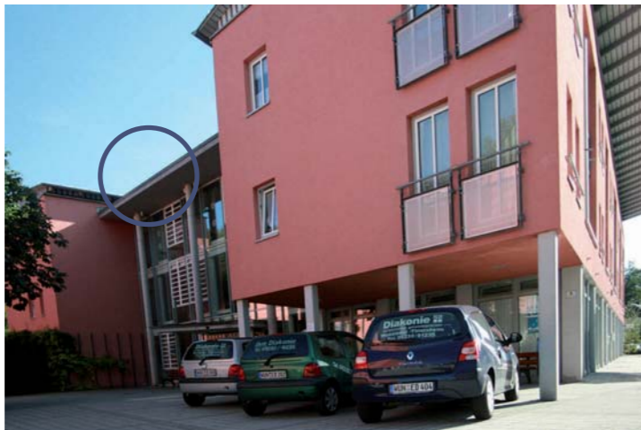
Zwergfledermausquartier hinter der Blechverkleidung am Dach des Seniorenheims in Wunsiedel
